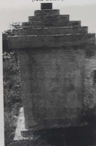
Detalle de faltante de placa y fisura en el monumento parte posterior, (foto actual).
