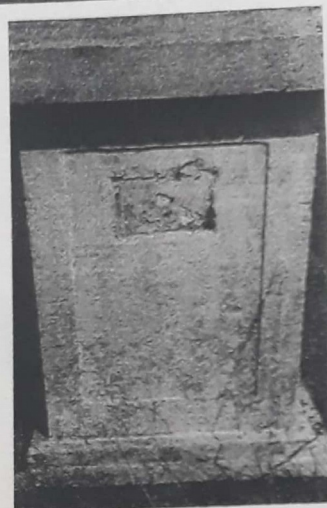
Detalle de faltante de placa en el monumento, lateral derecho, (foto actual).
